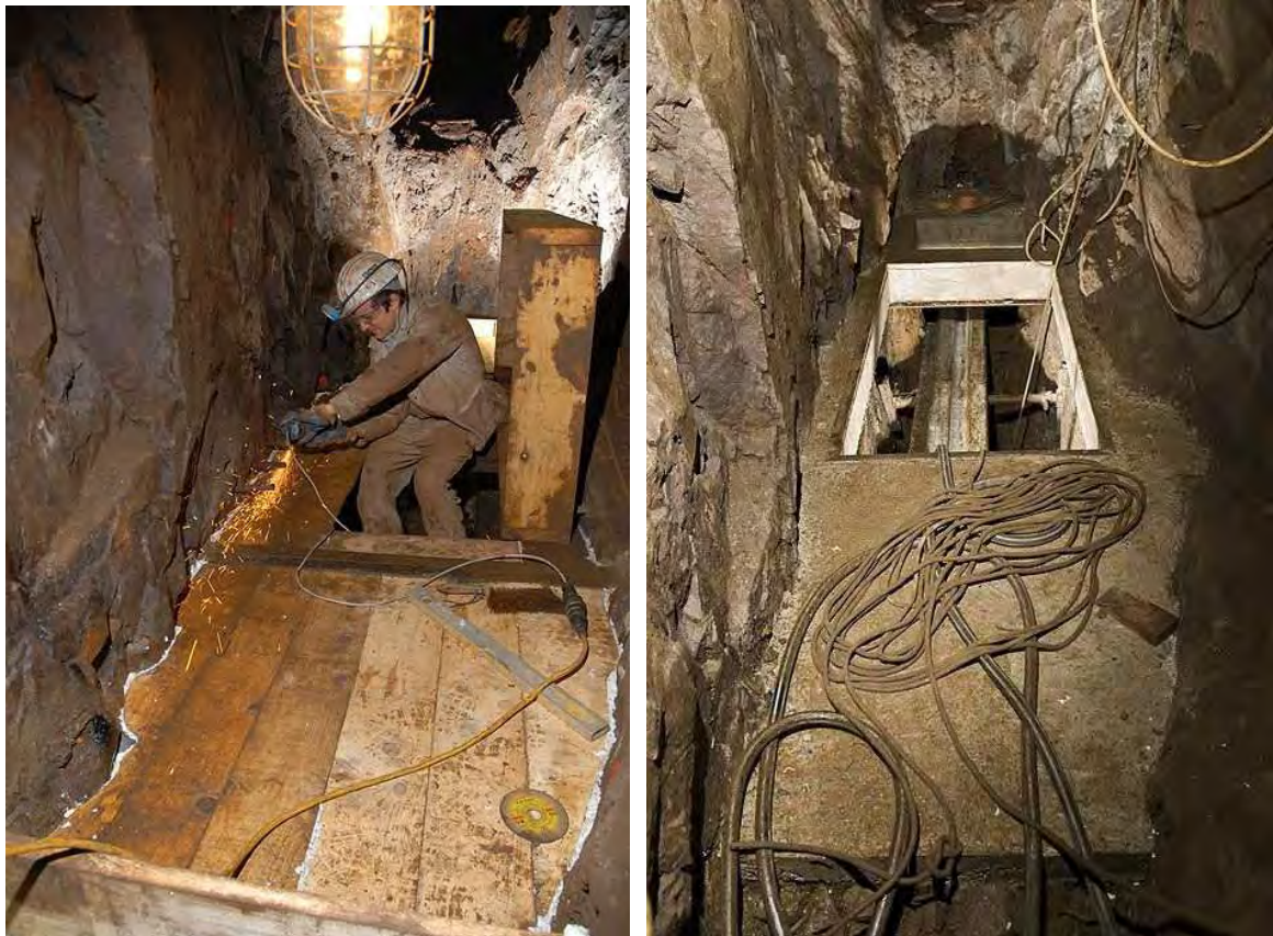
Erstellen der Schalung für die Betonbühne (links) und fertige Betonbühne (rechts) am Kopf vom Absinken 3
