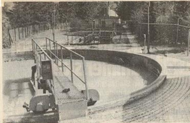
Eine andere Dimension: Die Kläranlage von St. Andreasberg mit dem Klärbekken im Vordergrund, das zum Rückhaltebecken umfunktioniert werden soll.
