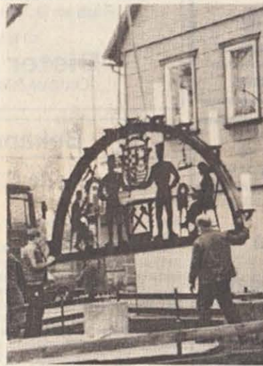
Der Schwibbogen hängt am Kran und schwebt langsam auf die Fundamente zu.
